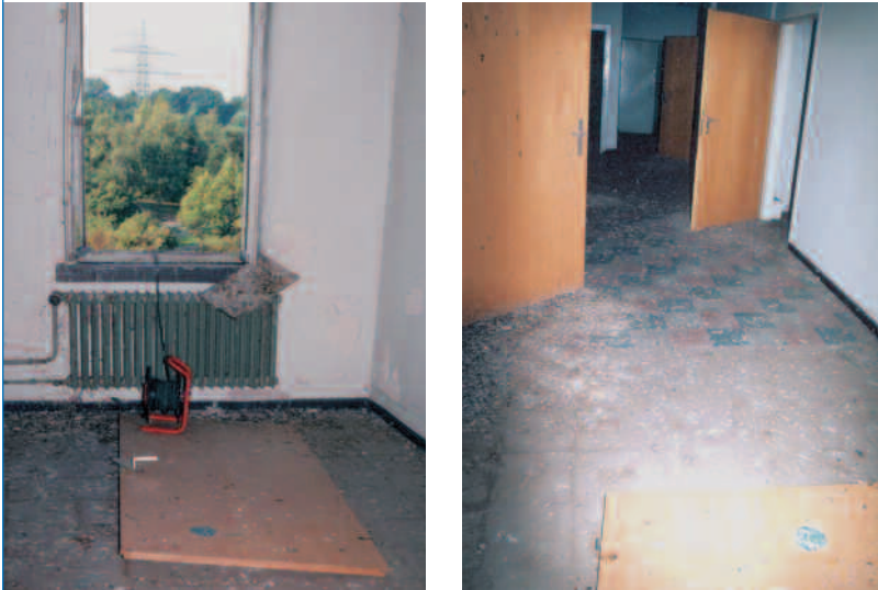
Abbildungen: 3 a, b. Taubenkotkontamination, die gut absaugbar ist
